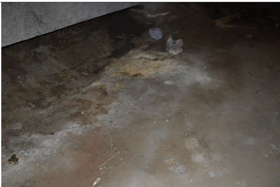
Фото №56. Осыпание и вымывание грунта под отдельными цокольными панелями в пространство технического подполья.
