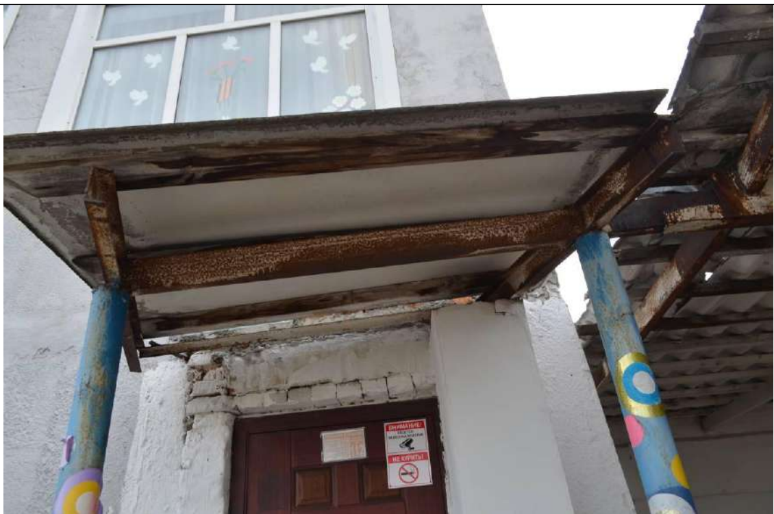
Фото №5. Коррозия элементов козырька, отсутствует колонна под козырек.
