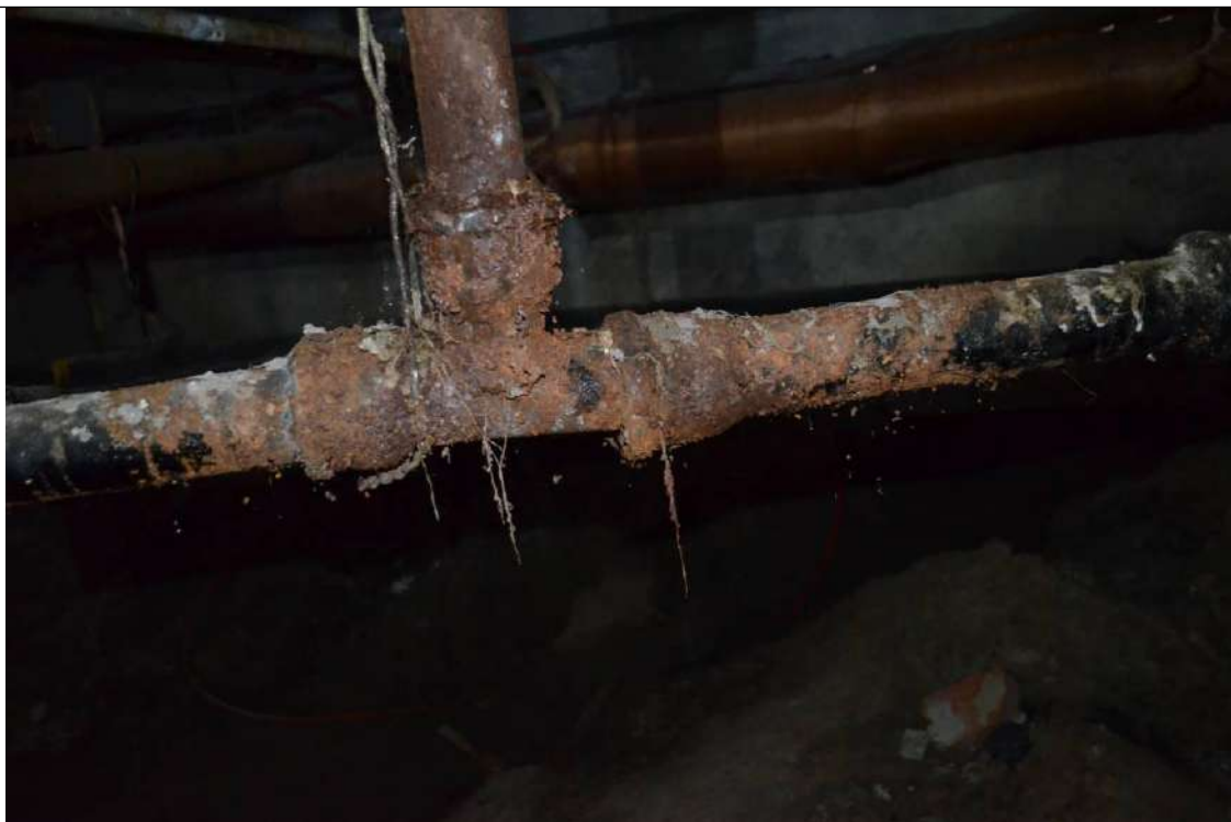
Фото №55. Общее состояние инженерных систем в техническом подполье.
