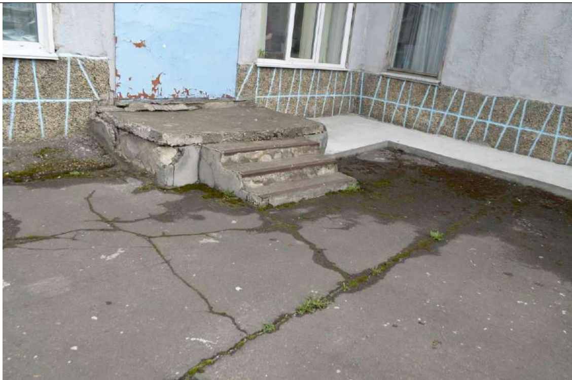
Фото №4. Разрушение бетонного крыльца.
