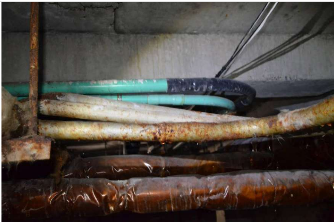
Фото №49. Общее состояние инженерных систем в техническом подполье.
