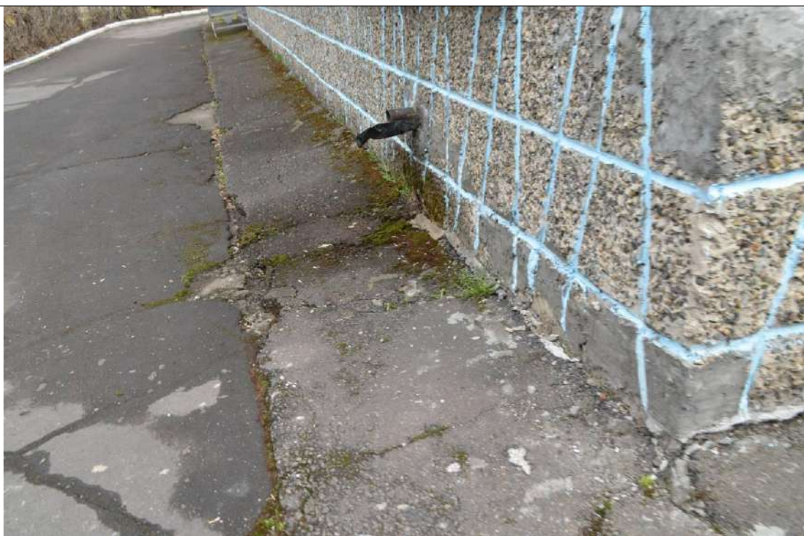
Фото №14. Трещины, сколы, выбоины, многочисленные участки разрушения бетонной отмостки
