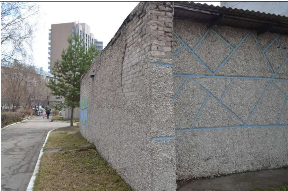
Фото №16. Отслоение декоративного штукатурного покрытия стен теневых навесов. Разрушение наружной версты кирпичной кладки.
