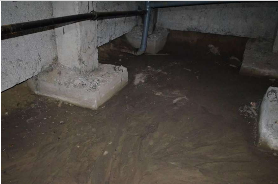
Фото №46. Осыпание и вымывание грунта под отдельными цокольными панелями в пространство технического подполья.
