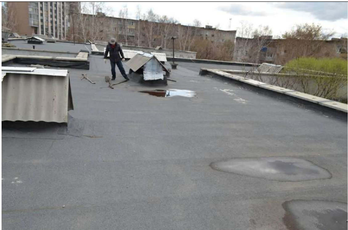
Фото №22. Застойные пятна от осадков на кровельном покрытии.
