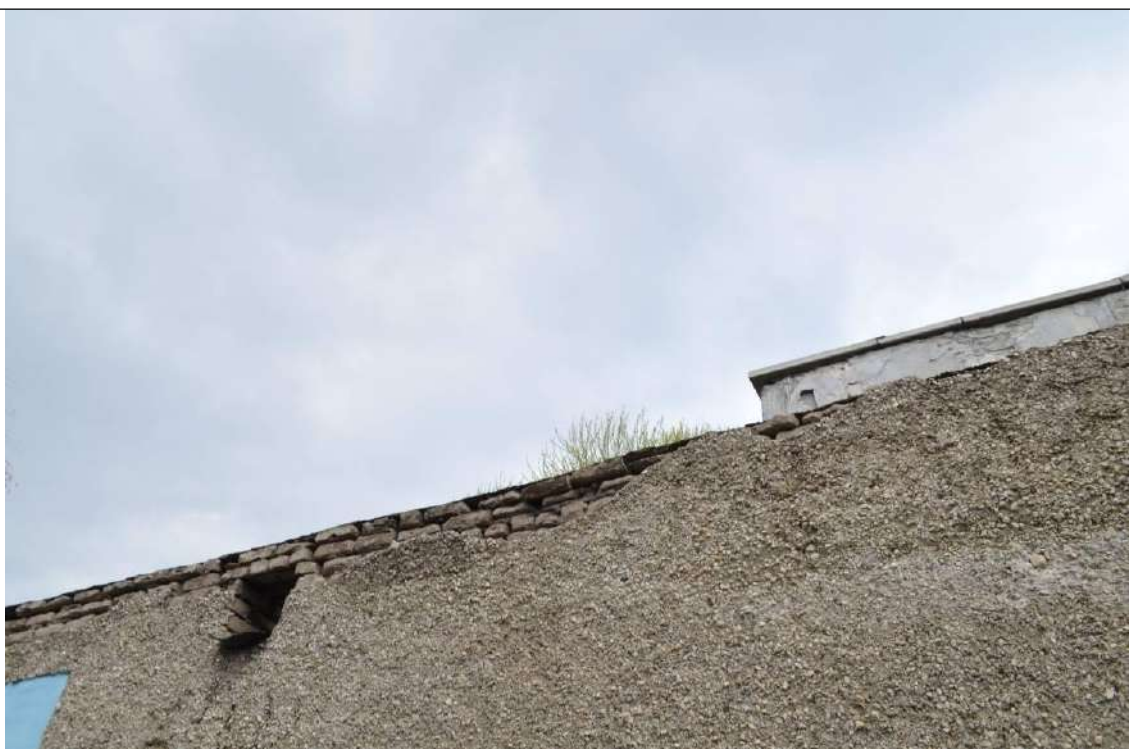
Фото №10. Отслоение декоративного штукатурного покрытия стен тентовых навесов. Разрушение наружной версты кирпичной кладки.
