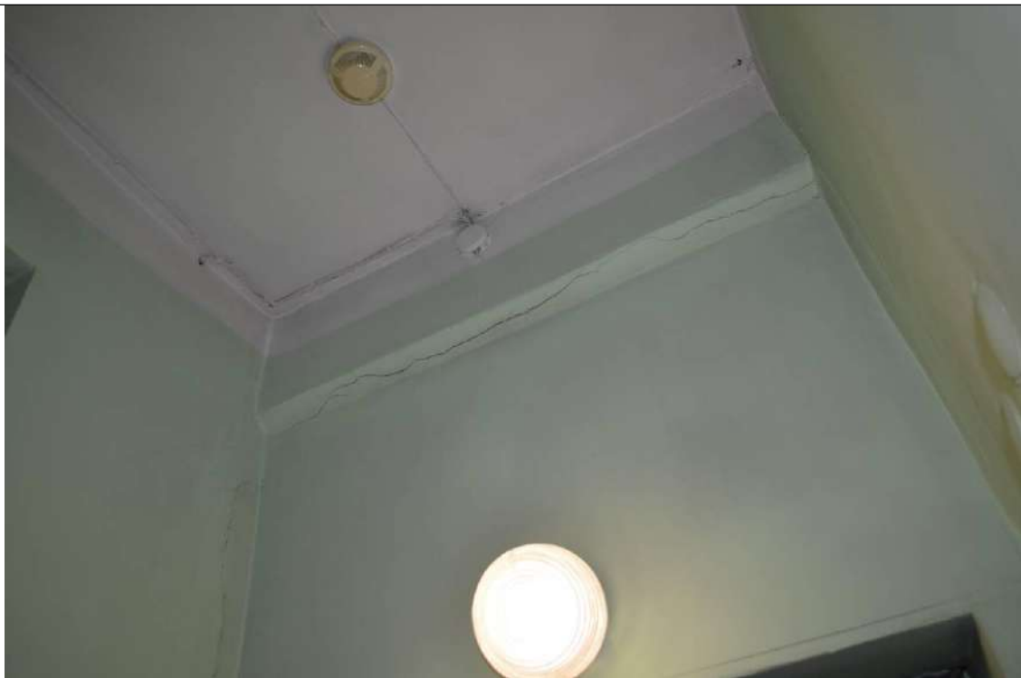
Фото №32. Дефекты отделочных покрытий.
