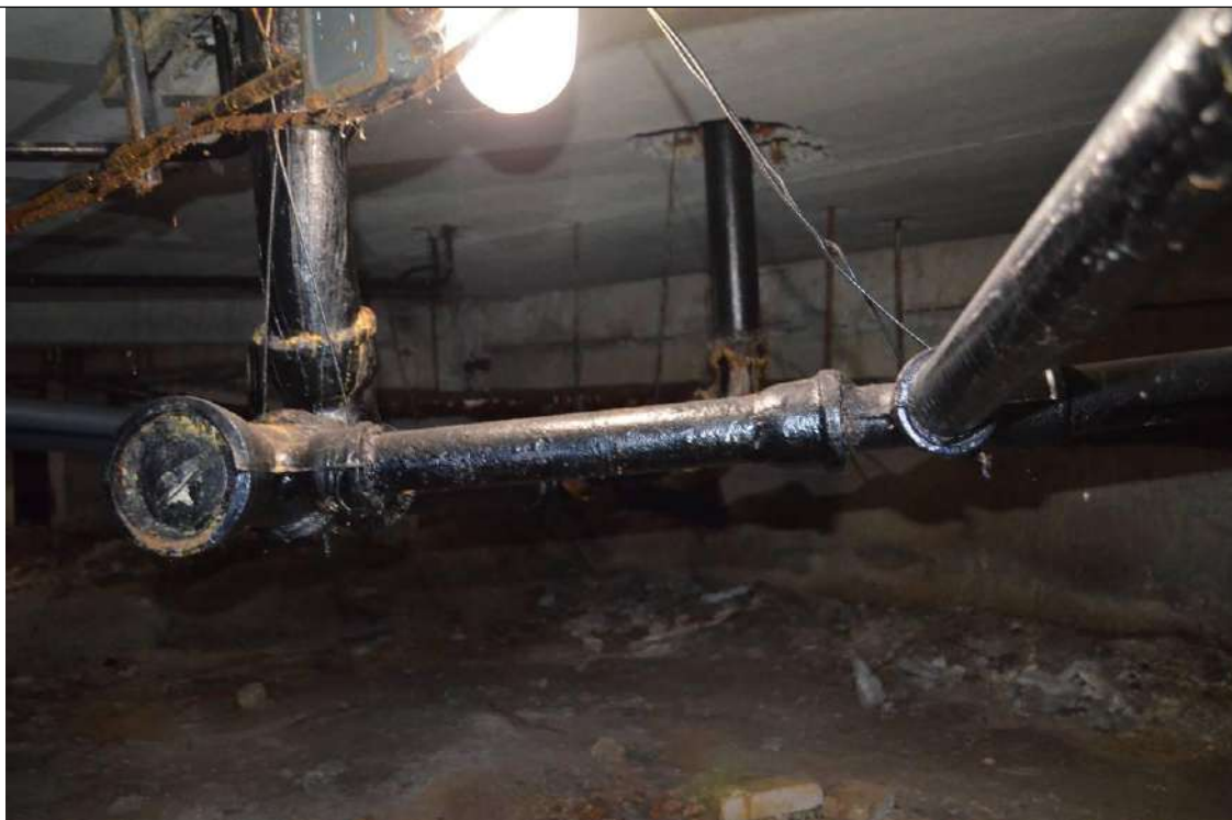
Фото №51. Общее состояние инженерных систем в техническом подполье.
