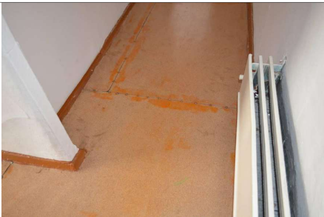
Фото №36. Состояние напольного покрытия.
