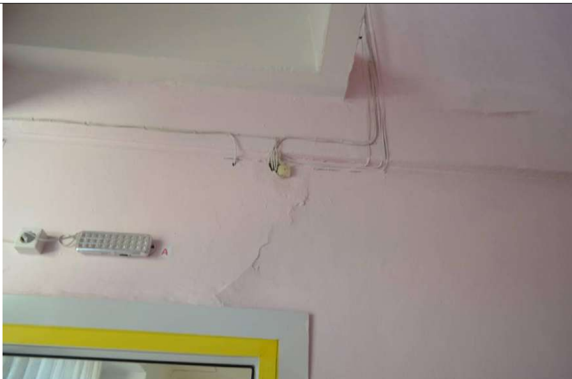
Фото №31. Дефекты отделочных покрытий.
