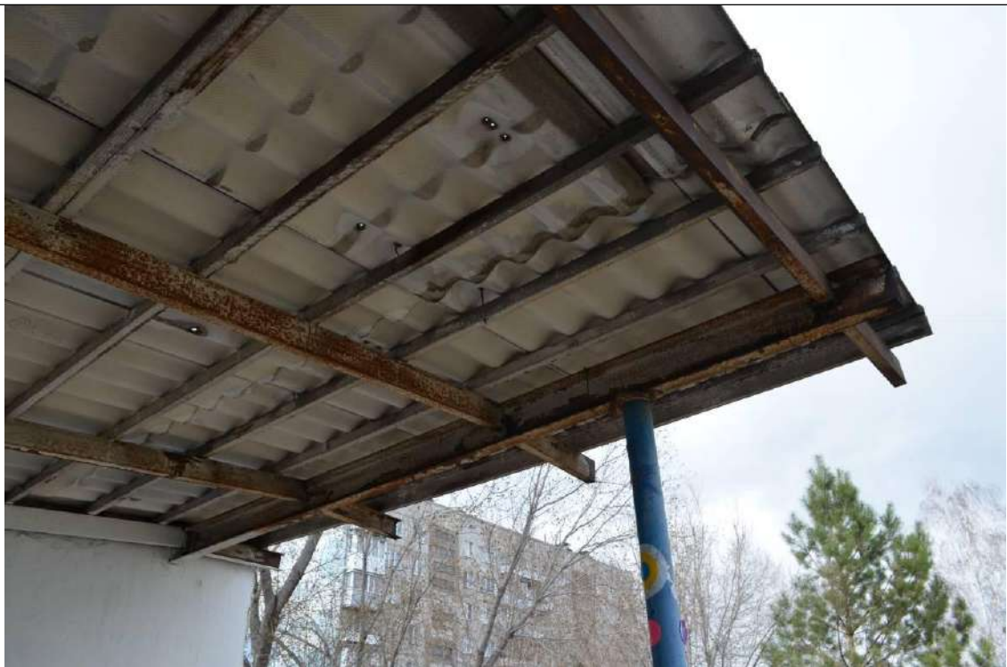
Фото №6. Поверхностная коррозия стальных элементов конструкций тентовых навесов. Отколы, трещины протечки, ослабление крепления листов шифера к обрешётке.
