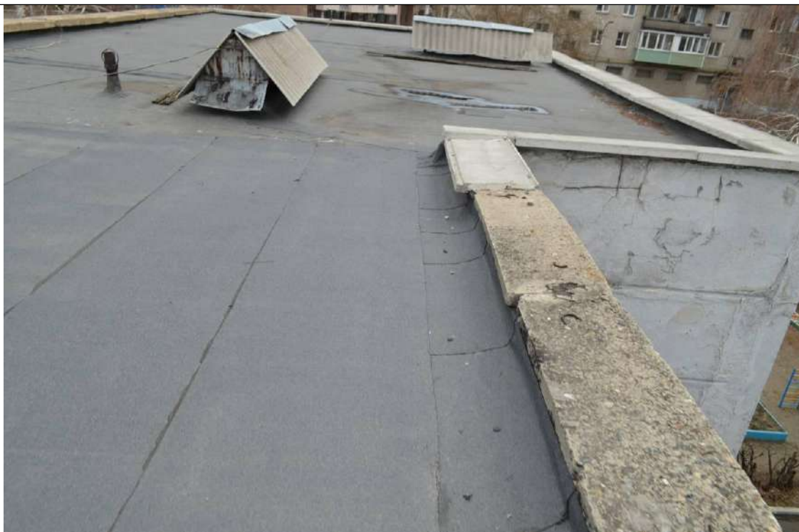
Фото №27. Разрушение защитного слоя бетона парапетных плит.
