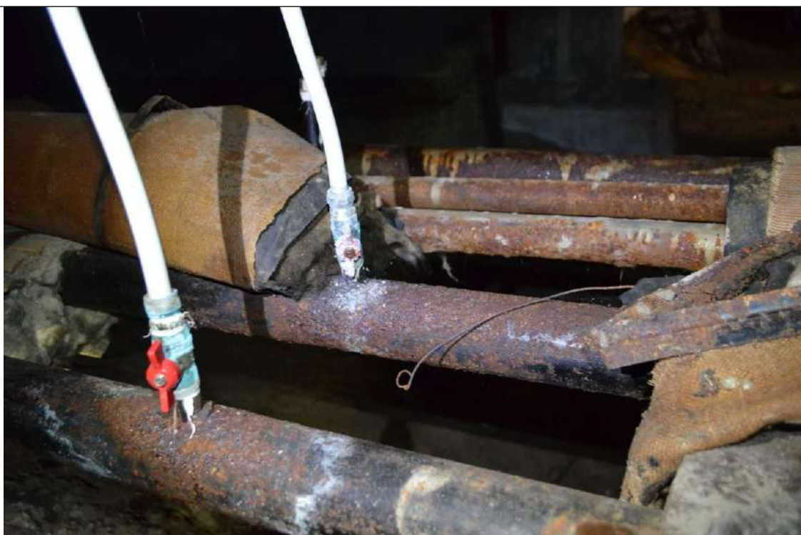
Фото №52. Общее состояние инженерных систем в техническом подполье.
