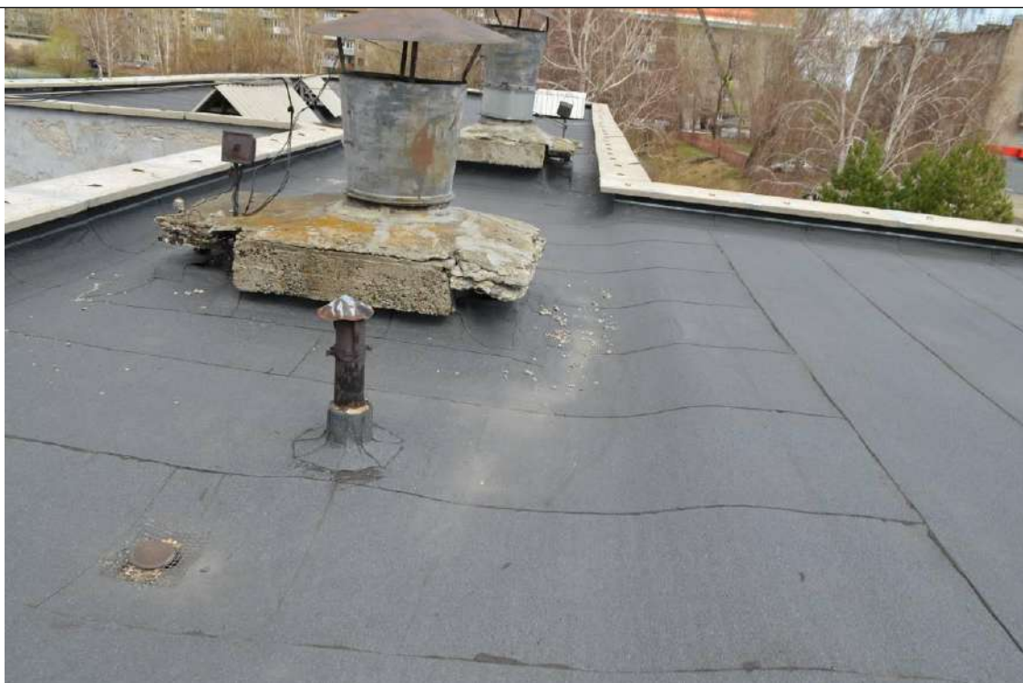
Фото №24. Разрушение бетонного вентиляционного канала.
