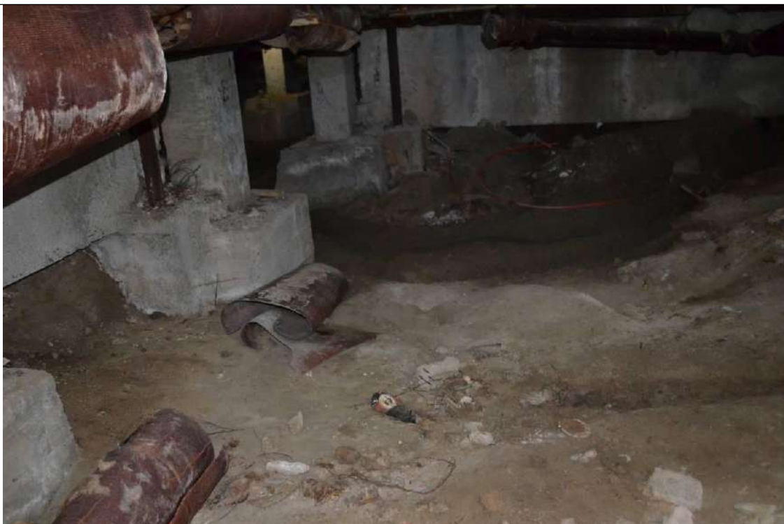
Фото №47. Осыпание и вымывание грунта под отдельными цокольными панелями в пространство технического подполья.
