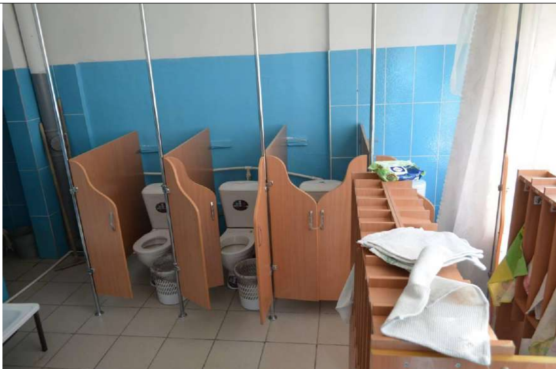
Фото №33. Состояние санузлов
