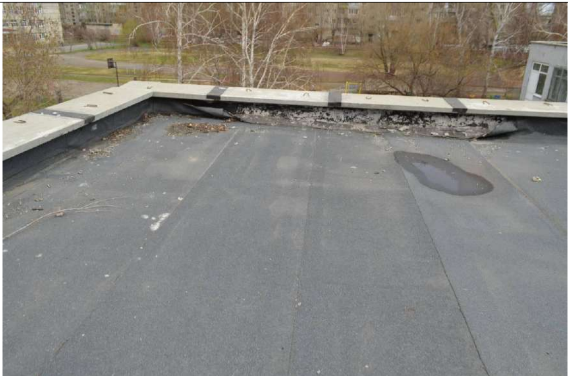
Фото №21. Локальные участки отслоения кровельного ковра от основания.
