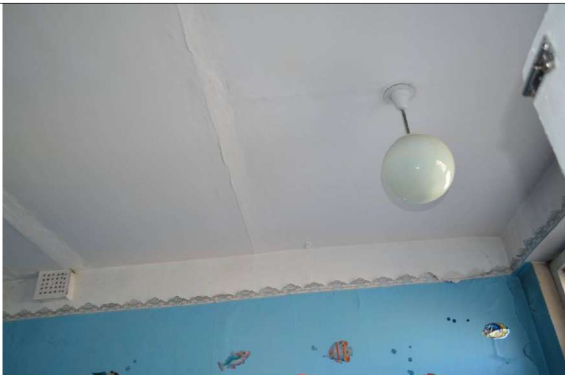
Фото №43. Дефекты на нижней поверхности плит перекрытия (трещины, неровности).
