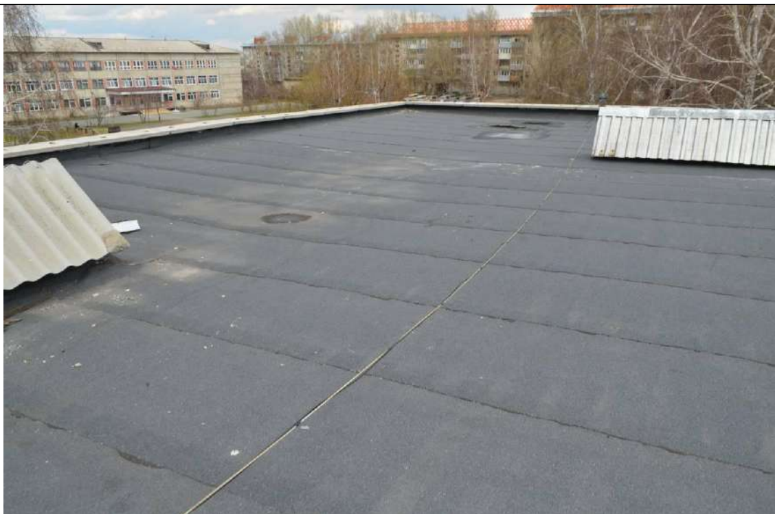
Фото №25. Застойные пятна от осадков на кровельном покрытии.
