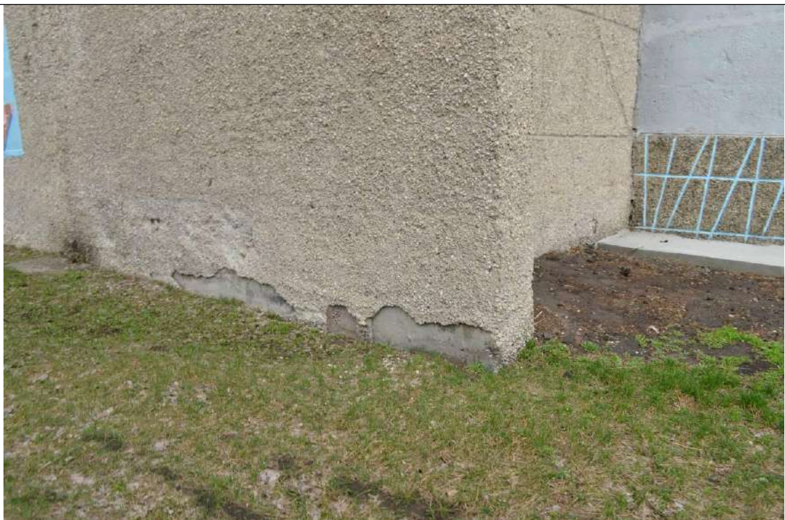
Фото №9. Отслоение декоративного штукатурного покрытия стен тентовых навесов.
