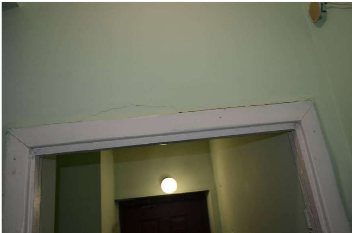
Фото №37. Дефекты отделочных покрытий.
