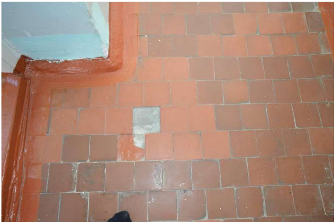
Фото №41. Дефекты напольных покрытий.
