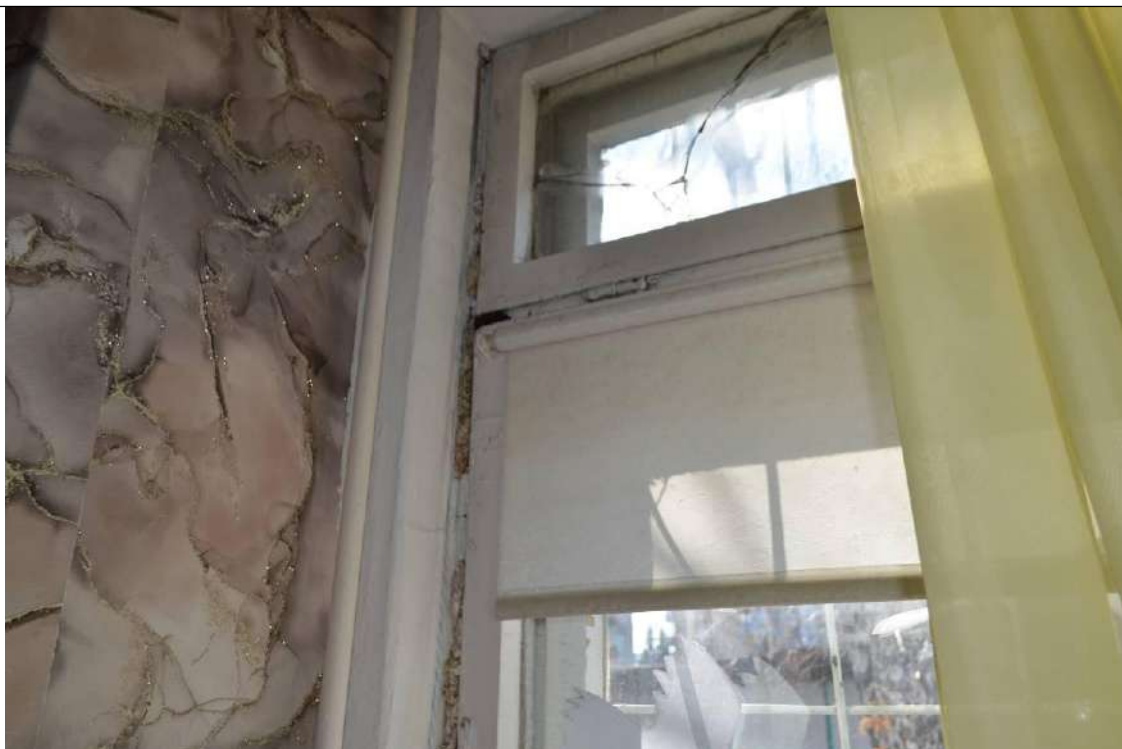
Фото №35. Состояние деревянных оконных блоков.
