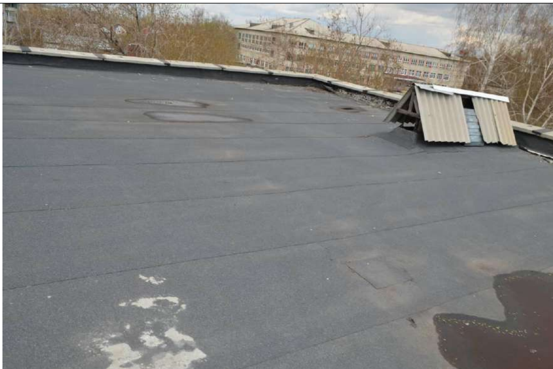
Фото №19. Застойные пятна от осадков на кровельном покрытии. Ветхое состояние кровли (асбестоцементные листы по деревянным элементам) над частью вентиляционных каналов
