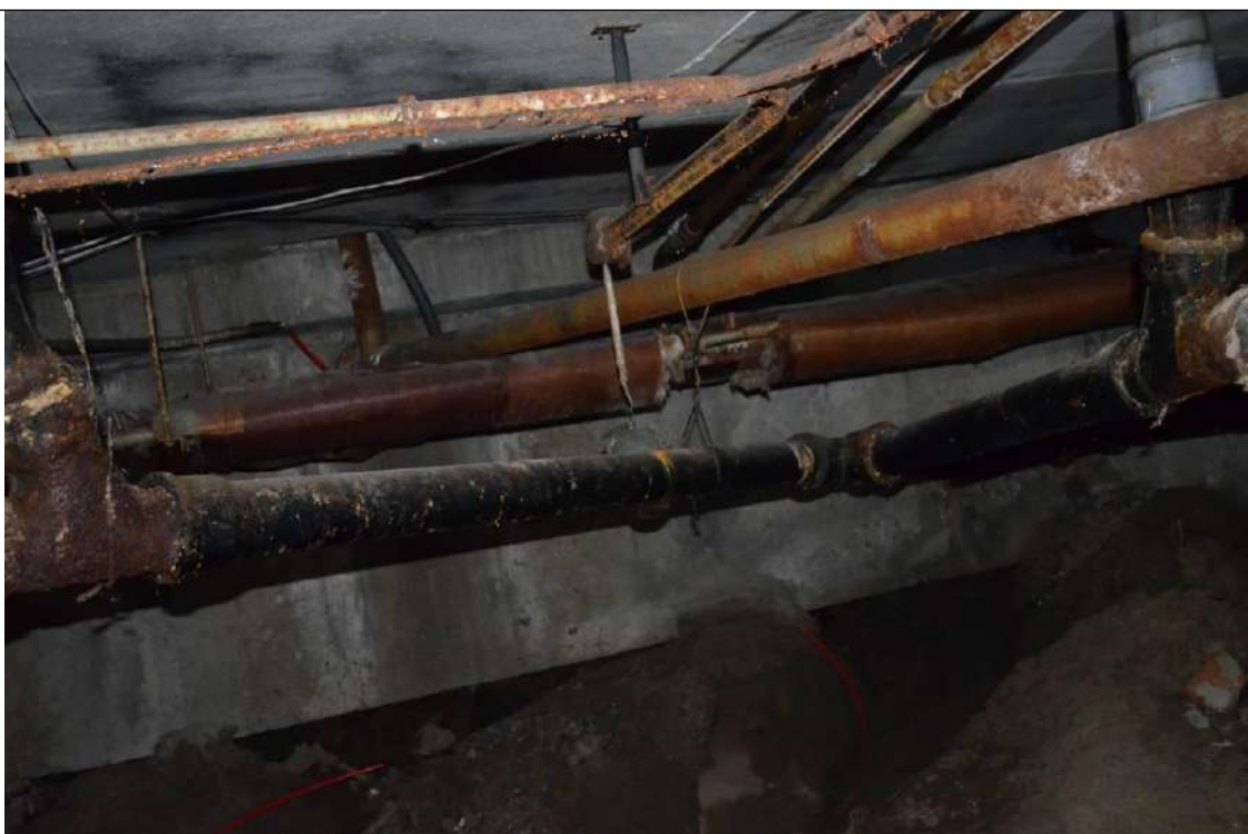
Фото №48. Общее состояние инженерных систем в техническом подполье.
