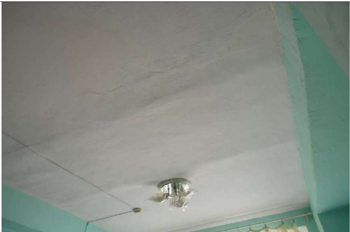
Фото №42. Дефекты на нижней поверхности плит перекрытия (трещины, неровности).
