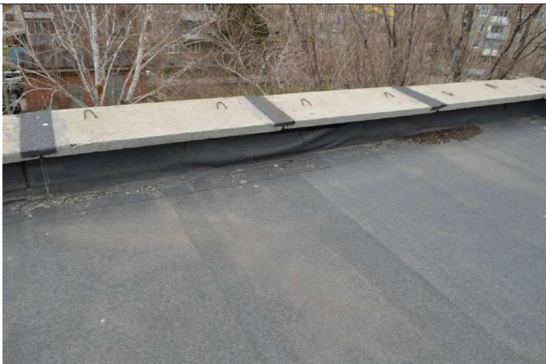
Фото №20. Локальные участки отслоения кровельного ковра от основания.
