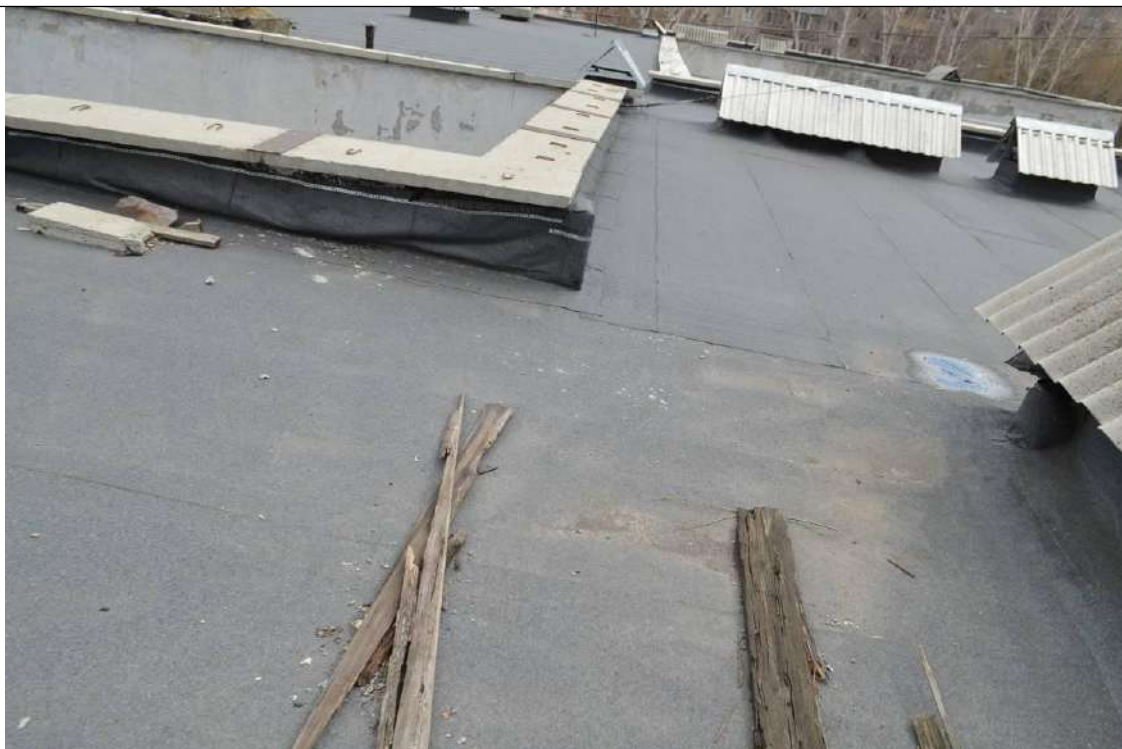
Фото №23. Локальные участки отслоения кровельного ковра от основания.
