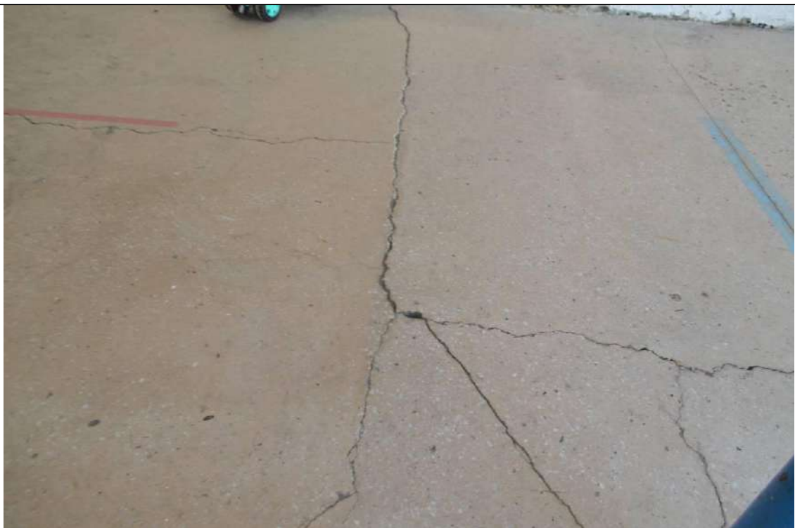
Фото №17. Сколы, выбоины, трещины бетонных площадок теневых навесов.
