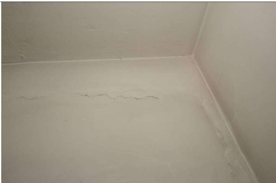
Фото №44. Дефекты отделочных покрытий.
