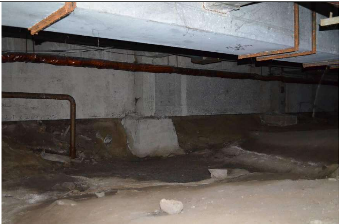
Фото №50. Осыпание и вымывание грунта под отдельными цокольными панелями в пространство технического подполья.
