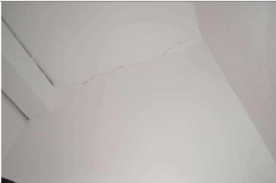
Фото №34. Дефекты отделочных покрытий.
