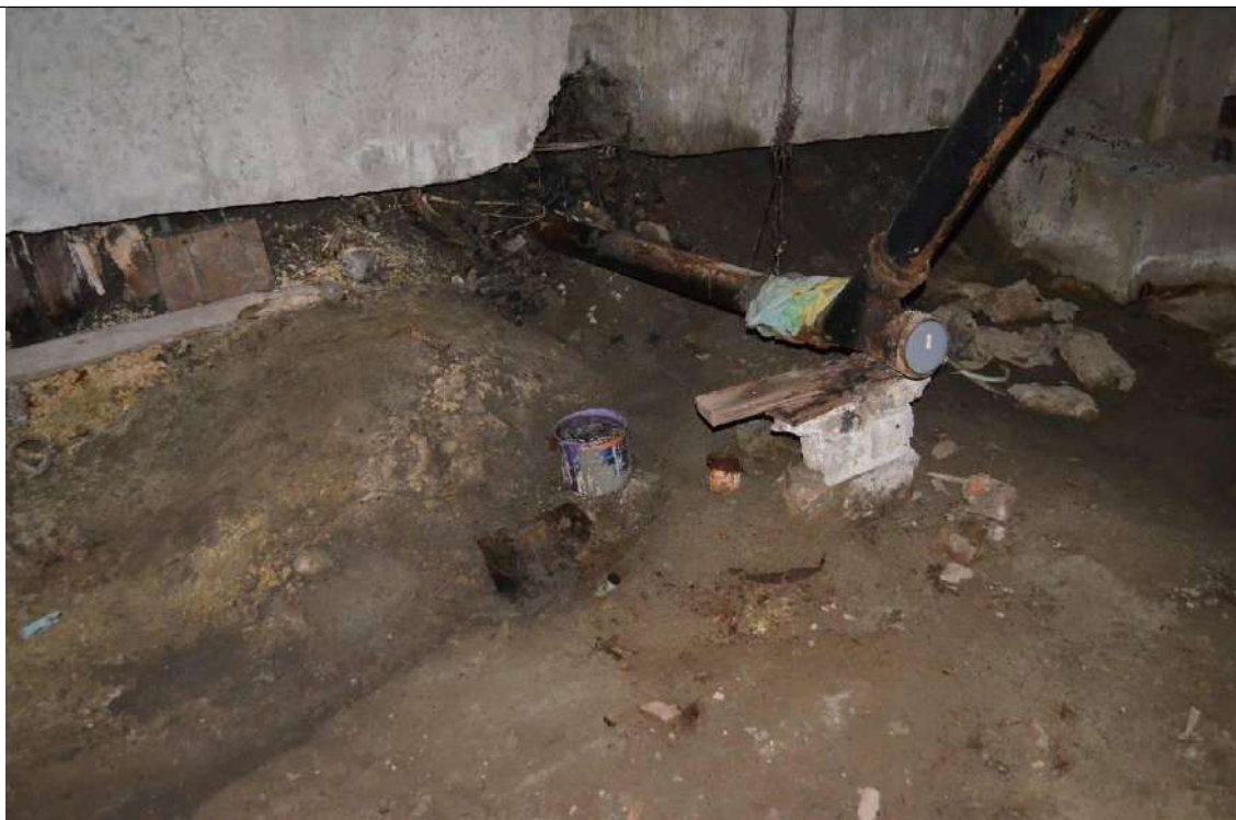
Фото №53. Общее состояние инженерных систем в техническом подполье.
